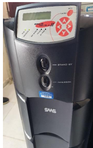
FIG 10 - Nobreak do Datacenter
