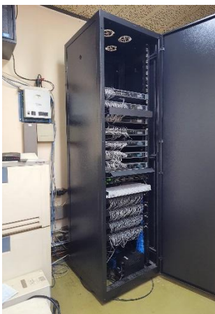
FIG 19 - Rack E Sala do DG
