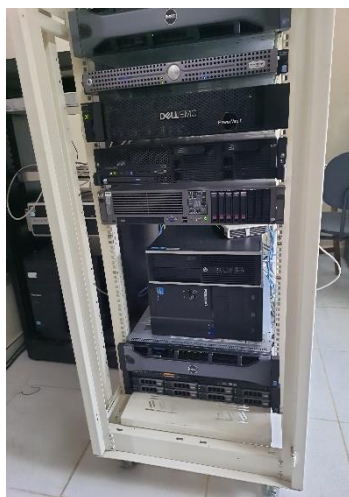
FIG 9 - Visão Parcial do Rack
