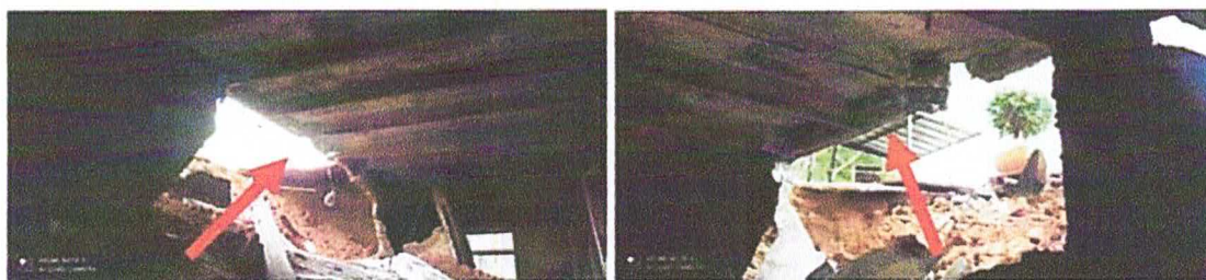
Fotos 09 e 10: destinadas a ilustrar o sistema estrutural na região do desabamento e assinalada a viga citada.
