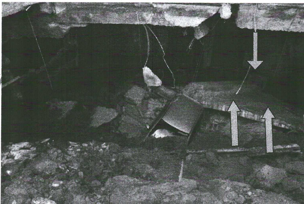
Fotografia 6: Vista superior frontal da situação final, onde estão indicadas por setas partes da estrutura de arrimo podendo-se observar posicionamento de bloco de fundação deslocado da frente para trás caracterizando resistência lateral insuficiente resultante das escavações internas.
