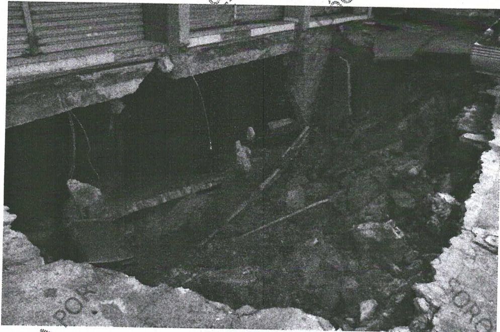
Fotografia 3 : Vista a parcial do resultado do desmoronamento onde à esquerda da fotografia observa-se o veículo que se encontrava sobre o ponto do calçamento.
