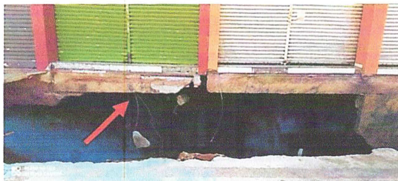
Foto 08: vista da viga citada acima (assinalada), sob a soleira das entradas-portões metálicos de enrolar das lojas.
