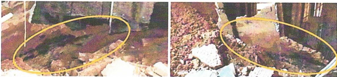
Fotos 35 e 36: destinadas a mostrar a pintura impermeabilizante existente, porém evidenciando a inexistência de cortina drenante cuja brita não foi encontrada.
