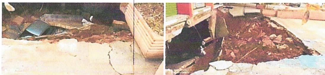
Fotos 06 e 07: vista da ruptura do pavimento de concreto simples do estacionamento, região assinalada na foto 05.
