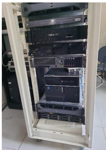
FIG 9 - Visão Parcial do Rack
