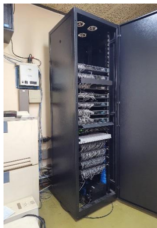
FIG 19 - Rack E Sala do DG
