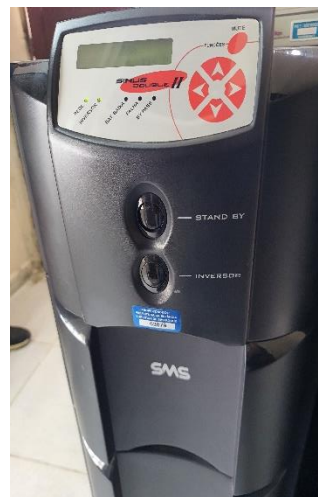
FIG 10 - Nobreak do Datacenter
